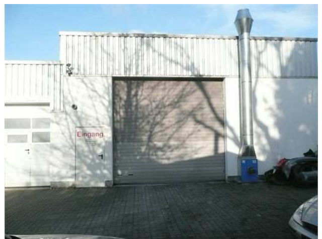
Abluftrohr mit dezentralem Absaugventilator
